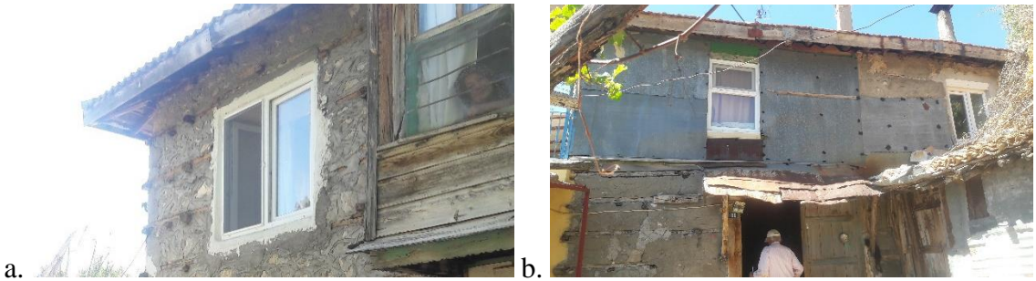
Şekil 4.99. a) Boyut ve malzemesi değiştirilmiş pencere; b) cephesi sac ile kaplanmış yapı (Orijinal 2018)
