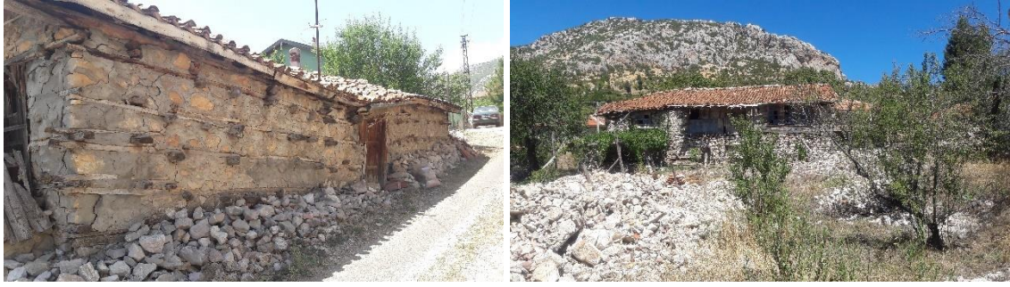
Şekil 4.61. Çimi Köyü strüktürel durumu kötü olan yapılar (Orijinal 2018)
