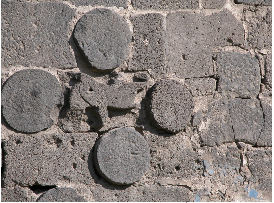
Res. 37 Eyyubi Burcu'nda Ters Konulmuş Kanatlı İnsan Figürü Onarım sonrası ters yerleştirilen figürde insan başı tahribe uğramıştır.
