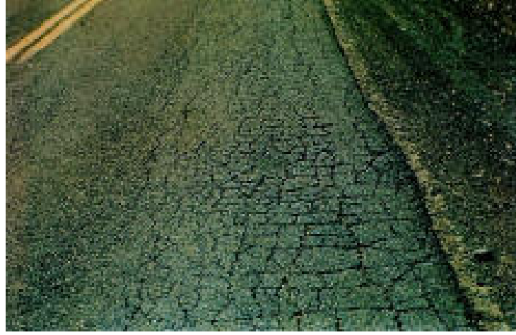
Şekil 3.26. Timsah sırtı çatlak
