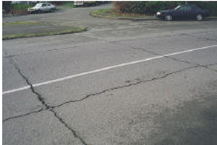
Şekil 3.31. Yüksek önemde yansıma çatlağı
