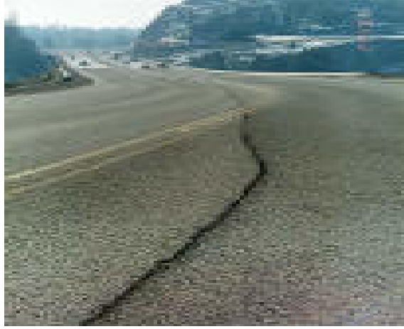
Şekil 3.30. Yüksek önemde boyuna çatlak
