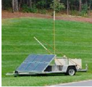
Şekil 3.37. Otoyollarda kullanılan radyo bilgilendirme sistemine ait aktarım istasyonu.
