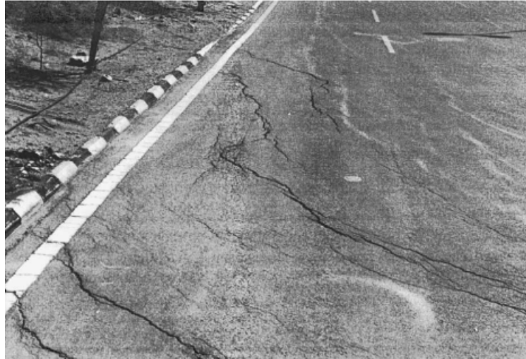
Şekil 1.2. Karayolu üst yapısında meydana gelen hasar (Al-Shamrani ve Dhowian, 2003)
