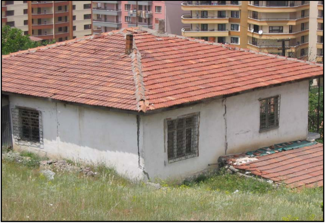
Şekil 4.7. 100. Yıl semtinde Ankara kili üzerinde inşa edilmiş gecekondu da şişmeye bağlı gelişmiş çatlaklar ve arka planda görülen çok katlı yeni yapılaşma alanı
