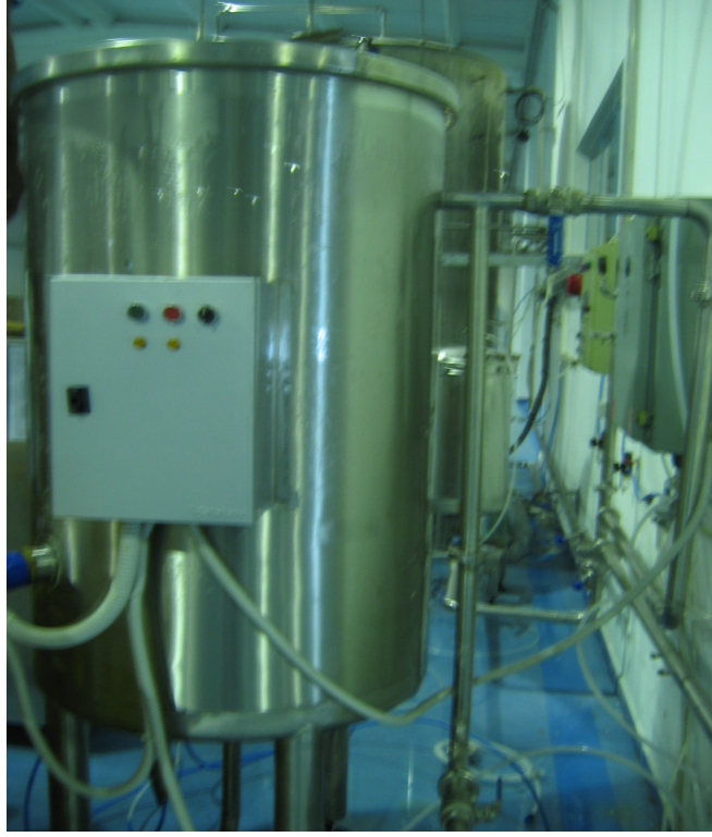
Şekil 3.2.1.2. Ön soğutma ve ozon uygulamasının yapıldığı su tankı
