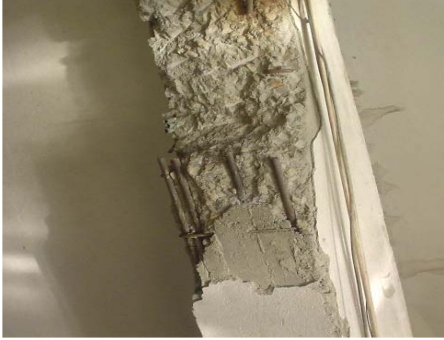
Şekil 4.46. Sanayi yapısında kullanıcı tarafından hasar verilen kiriş
