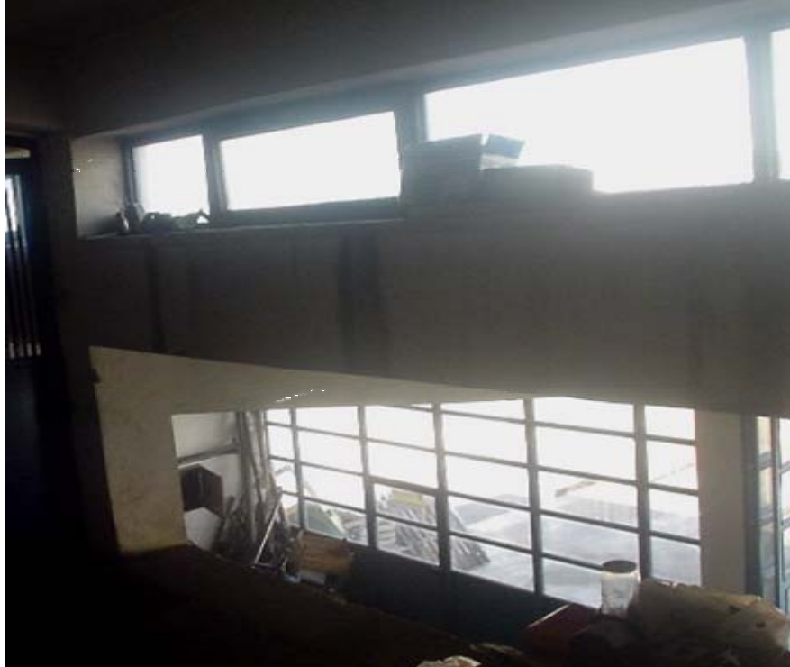
Şekil 4.43. Sanayi yapısında kısa kolon oluşumu görüntüsü
