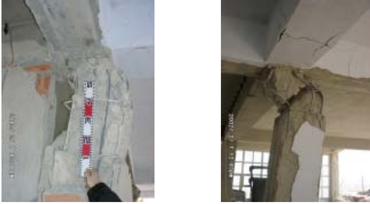
Şekil 2.2. Çay sanayi sitesinde kolon burkulmaları (Sağlamer vd., 2002)
