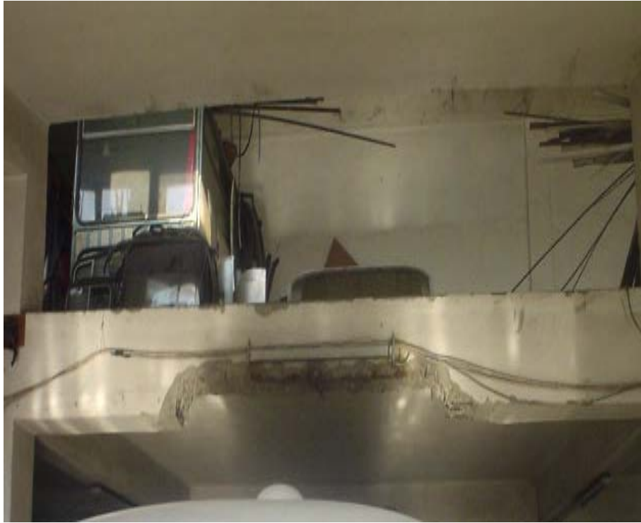
Şekil 4.45. Sanayi yapısında kullanıcı tarafından hasar verilen kiriş
