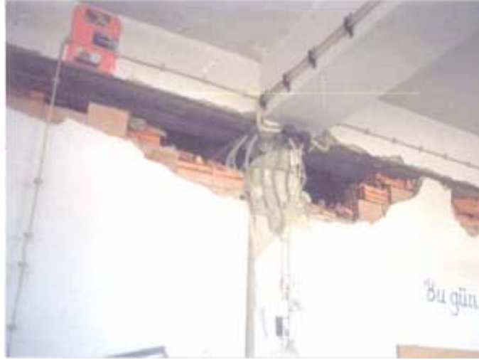
Şekil 2.9. Çay Küçük Sanayi Sitesinde iç aks kolonunda basınç kırılması (Bayülke vd., 2003)
