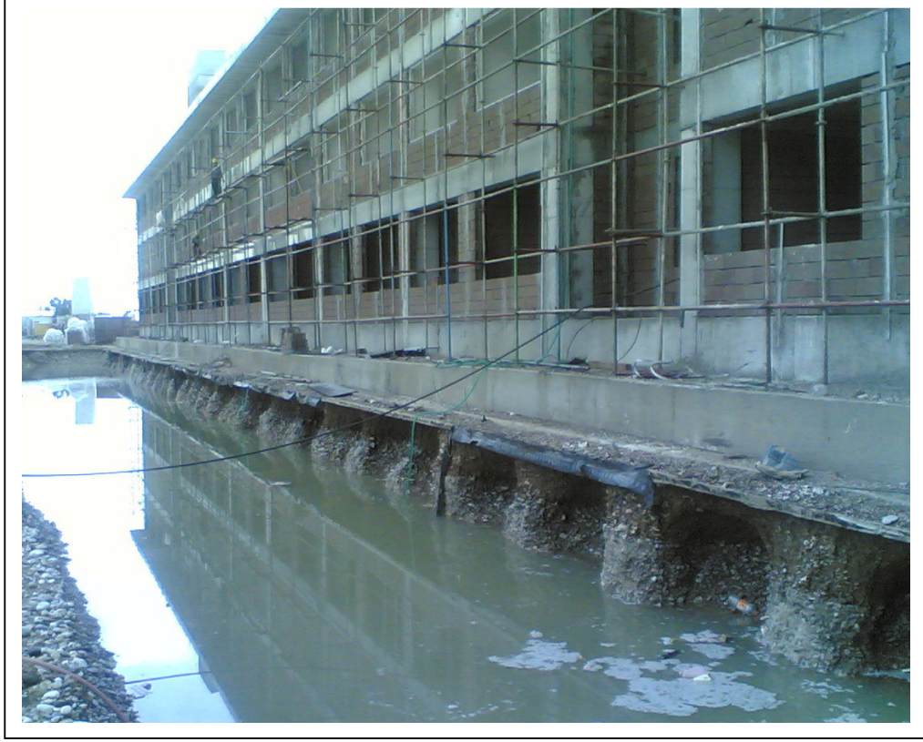
Şekil 4.7. İstanbul oteli lojmanları galeri çukurları ve radye temel altı jet grout kolonları
