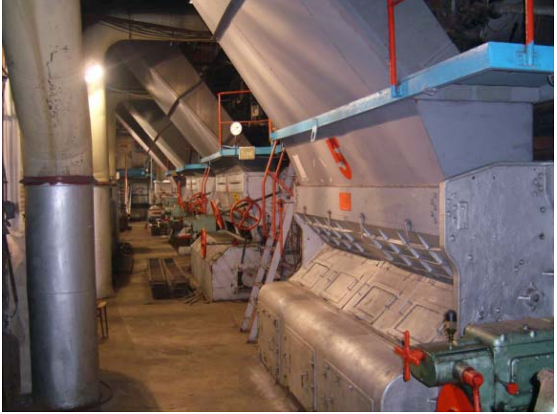
Şekil 3.2 Alpullu şeker fabrikası kazan dairesi
