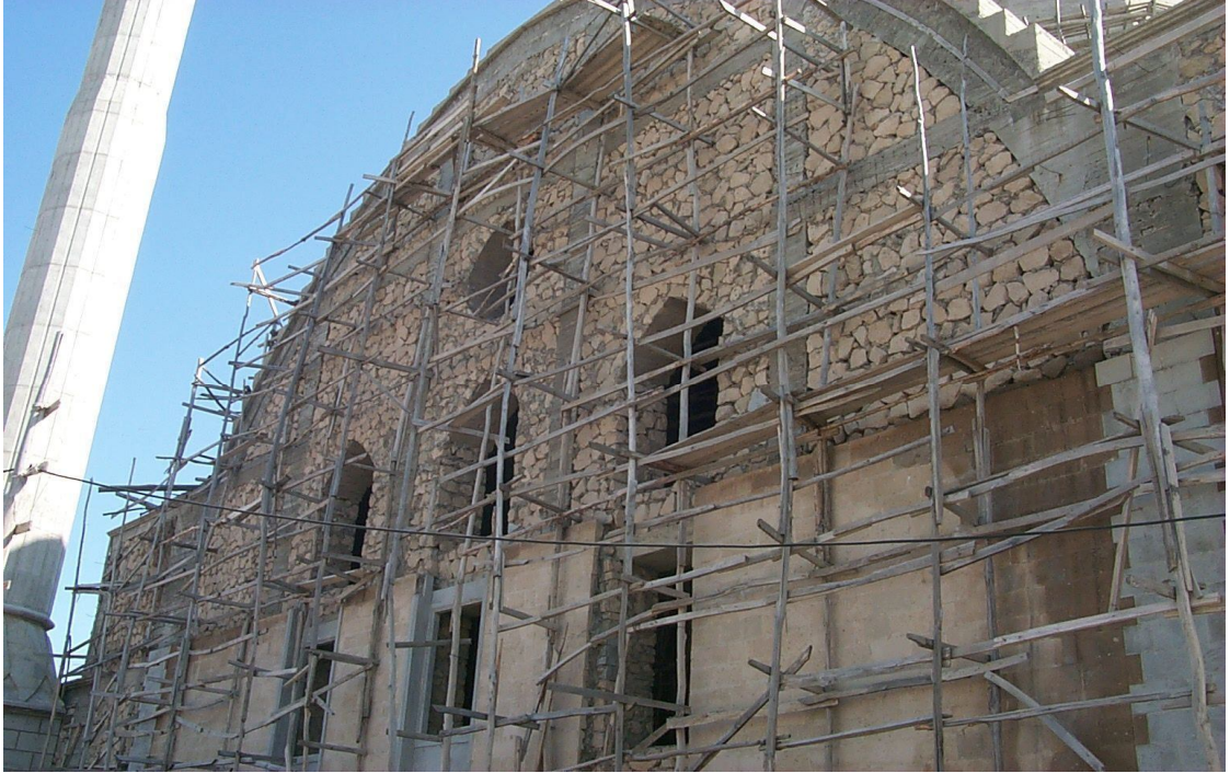
Őekil E-2: Cami duvarında tűf kaplaması
