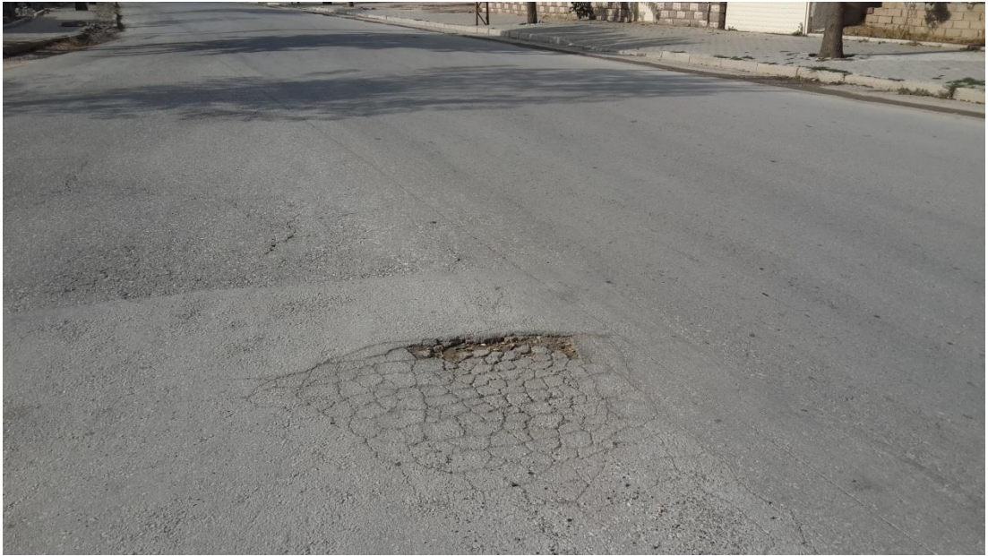
Şekil 4.21. Deneme güzergahındaki timsah sırtı çatlaklar ve çukurlar
