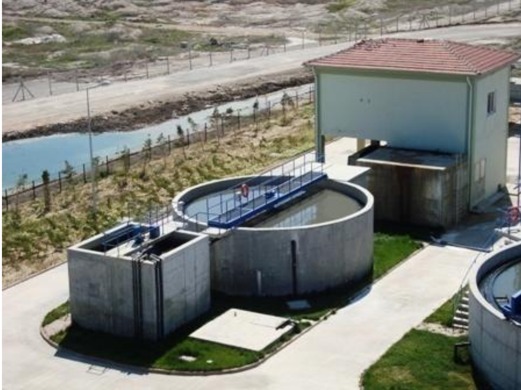
Şekil 3.17. KOS AAT çamur dengeleme ve çamur yoğunlaştırma havuzu
