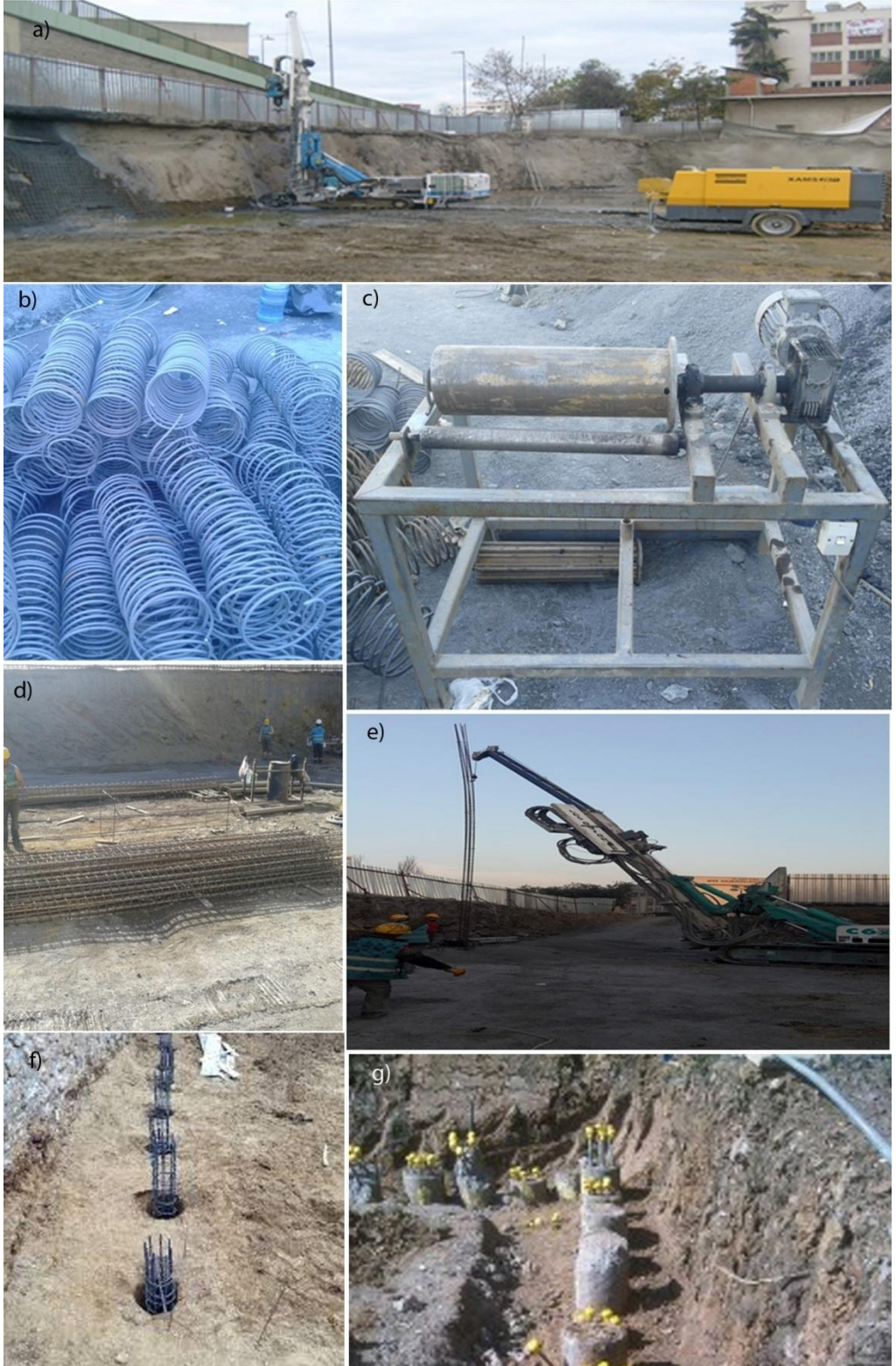
Resim 4.10. Mini kazık uygulama aşamalarından genel görünüm (a: delgi işleminin yapılması, b: sarmal etre, c: etre makinesi, d: donatıların hazırlanması, e: donatının delik içerisine yerleştirilmesi, f: donatının delik içindeki konumu, g: beton dökülmüş ve tamamlanmış kazıklar)
