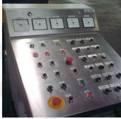
Şekil 6.4. Giriş operatör panosu
