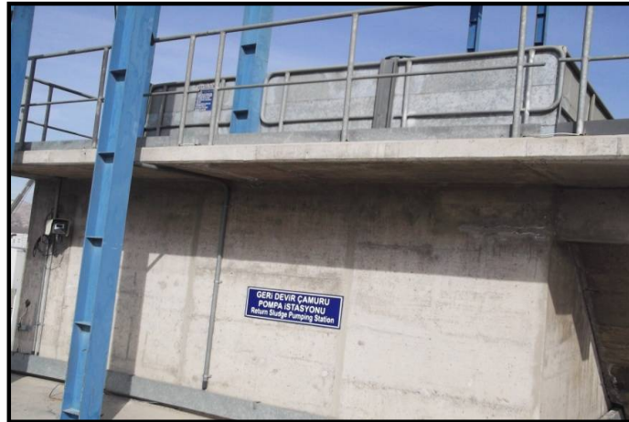
Resim 2.26. Geri devir çamuru pompa istasyonu [58]
