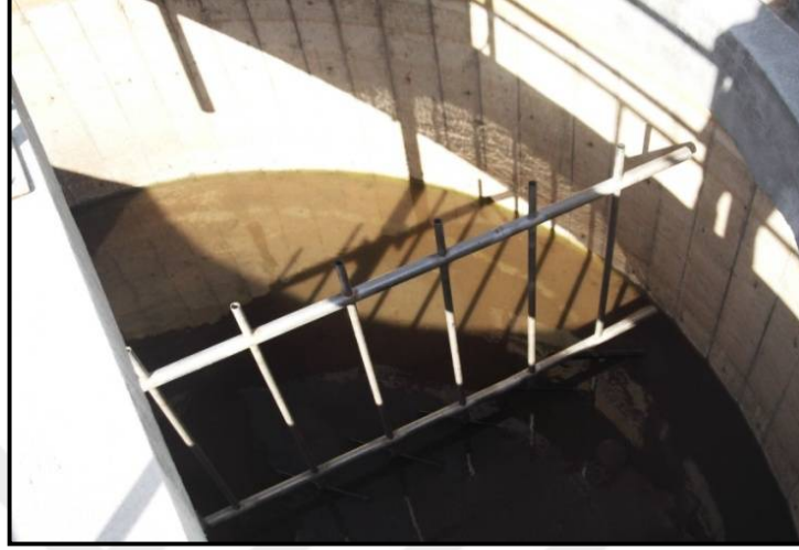
Resim 2.37. Çamur yoğunlaştırma bölümü [58]
