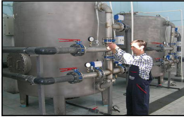
Resim 2.8. Klor dozajlama ünitesi [3].
