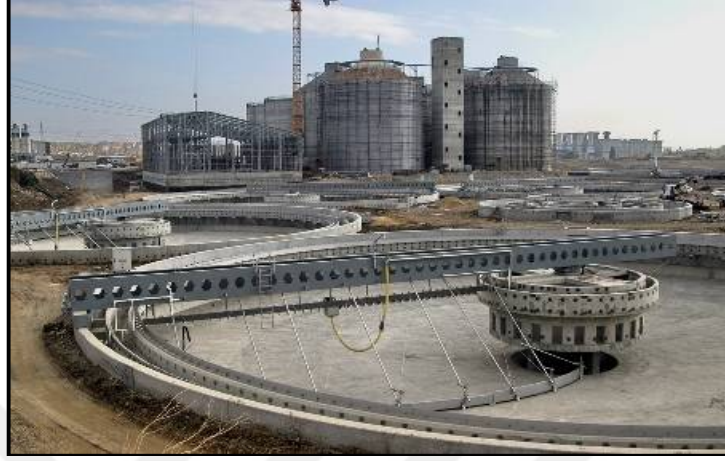
Resim 2.14. Paşaköy Biyolojik Arıtma Tesisi [52]
