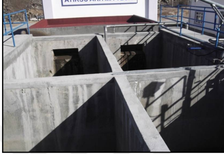
Resim 2.35. Ön havalandırma havuzları [58]
