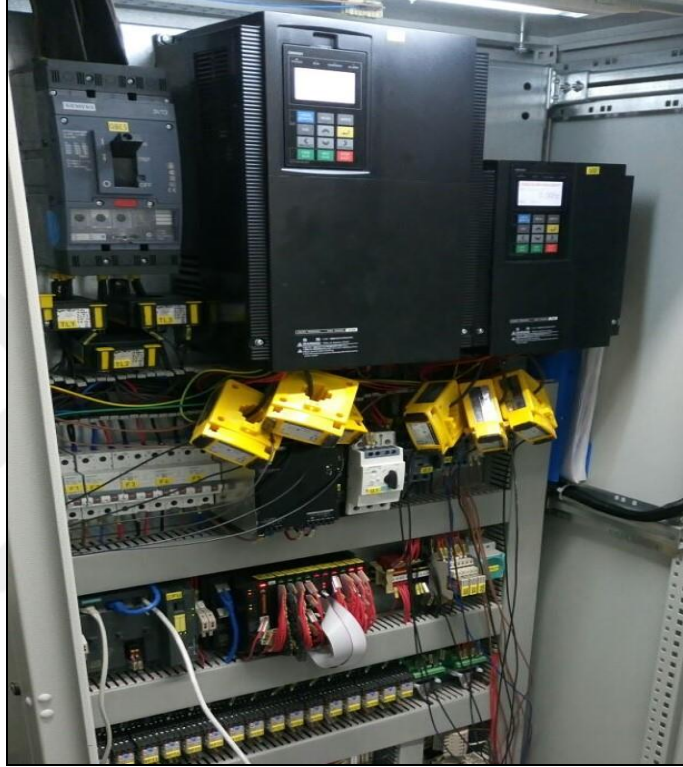
Şekil 3.10. Elektrik kumanda ve otomasyon panosu
