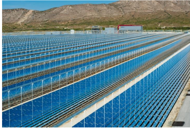
Şekil 3.13. Doğrusal fresnel kollektörler ile çalışan santral (Novatec Solar, 2013)
