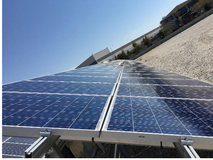
Şekil 11.7: Temizlik Sonrası Güneş Panelleri
