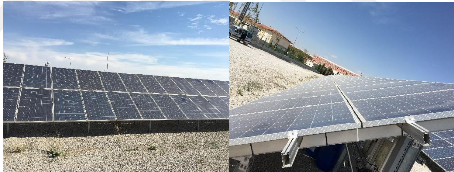
Şekil 11.4: Konya OSB Temizlik Yapılmamış Güneş Panelleri
