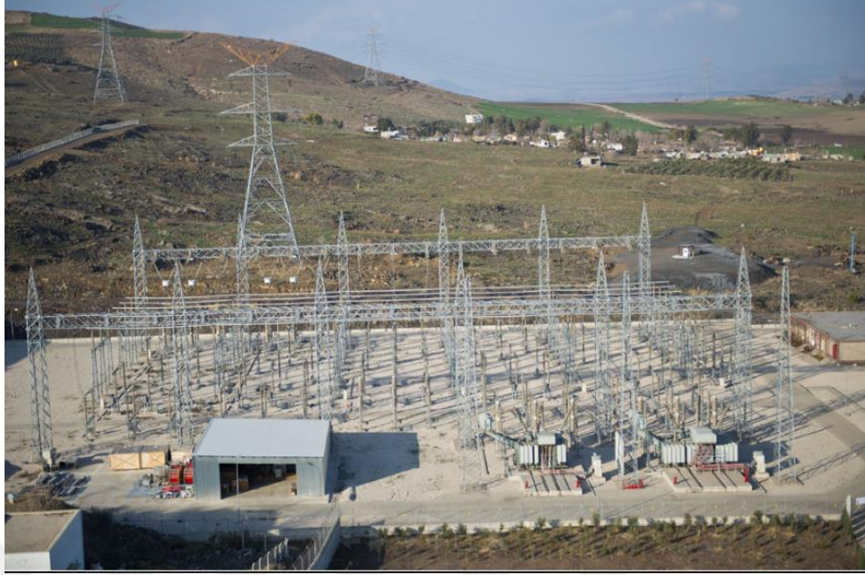
Şekil 6.5. Baştuğ Metalürji şalt tesisinden genel görünüm [78]
