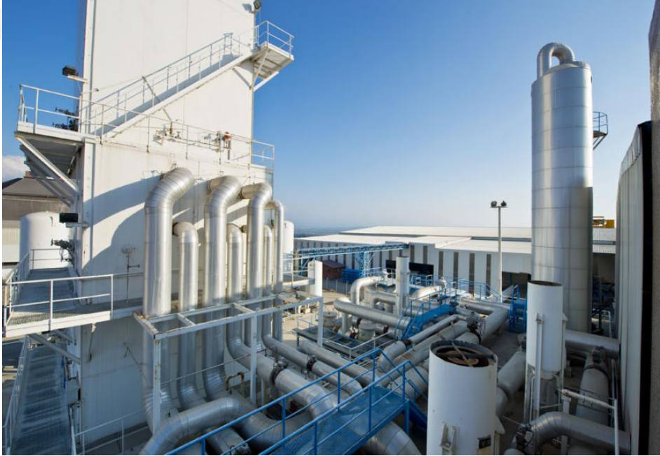
Şekil 6.4. Baştuğ Metalürji oksijen üretim tesisinden genel görünüm [78]
