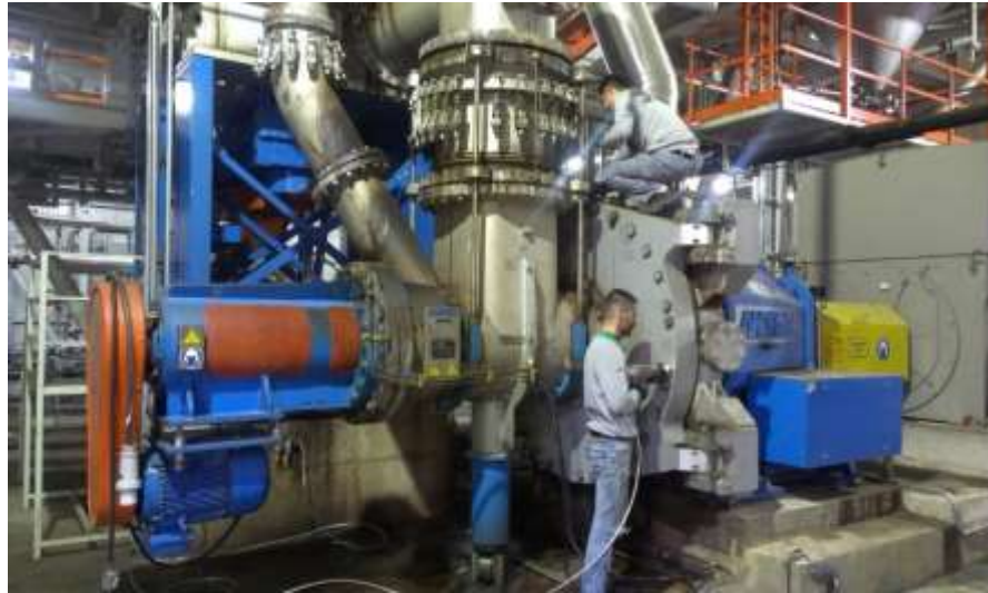
Şekil 1.5. MDF fabrikasında rafinör ünitesi
