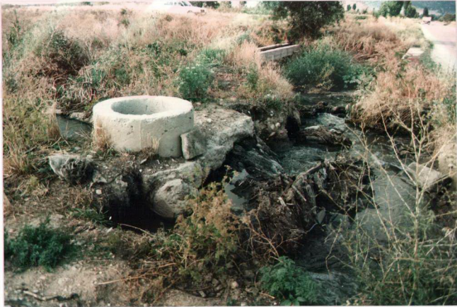
Fotograf 2. Kent Kanalizasyonu 1 Nolu Deşarj Noktası (F.Altıntabak)
