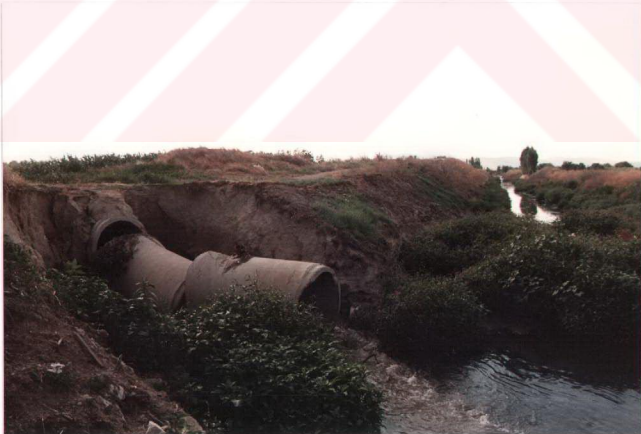
Fotoğraf 4. Kent Kanalizasyonu 2 Nolu Deşarj Noktası (F.Altıntabak)
