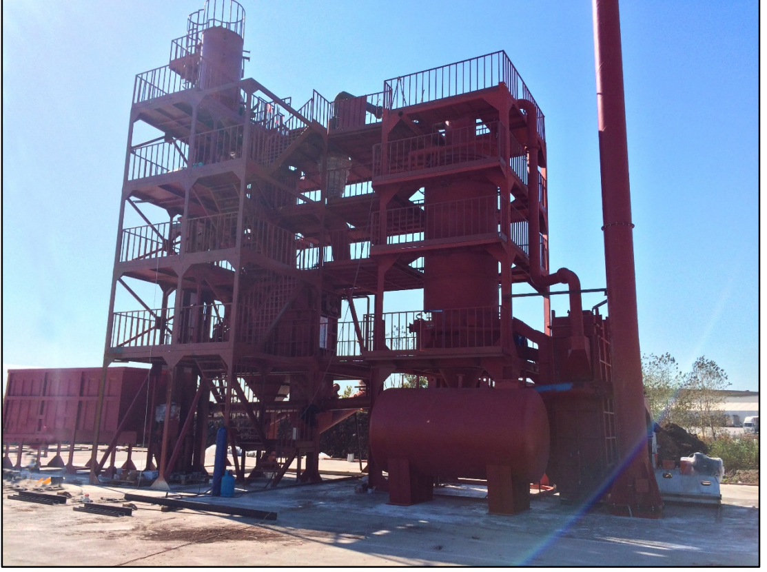
Şekil 3.7: Pilot ölçekli gazlaştırma sistemi görünümü.
