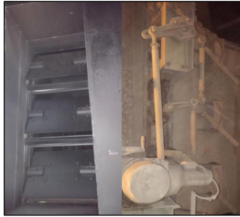
Şekil 5.2: Yakma hava klapeleleri ve ayar mekanizmasının görünümü.
