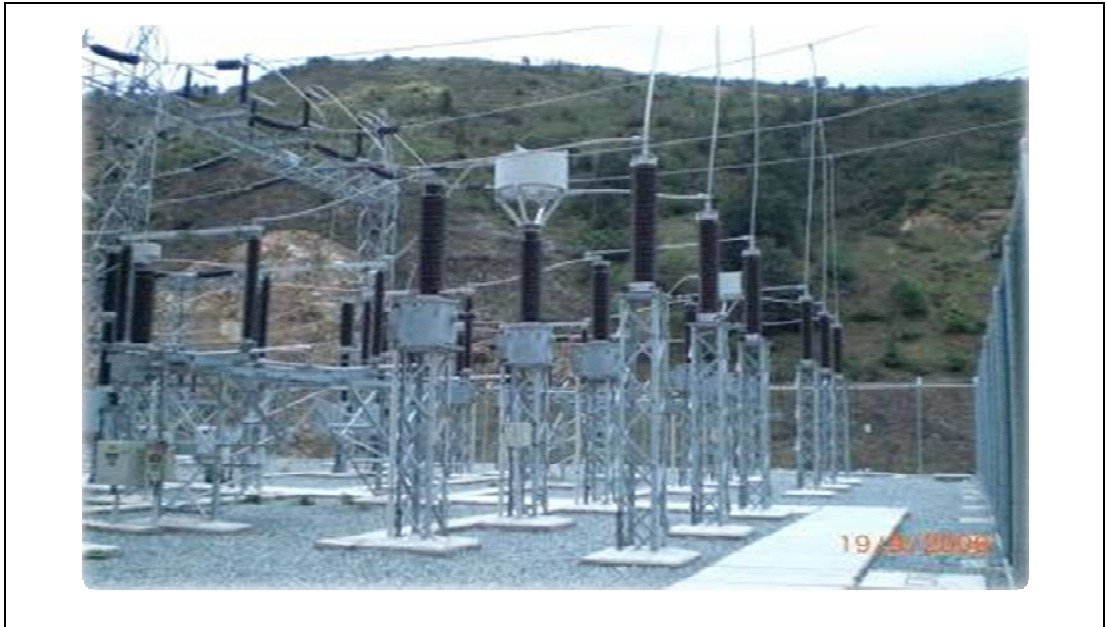
Şekil 3.10: Şalt alanı görünüm örneği.
