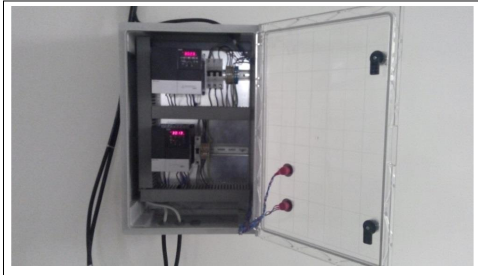
Şekil 3.5: Fan kontrol panosu.
