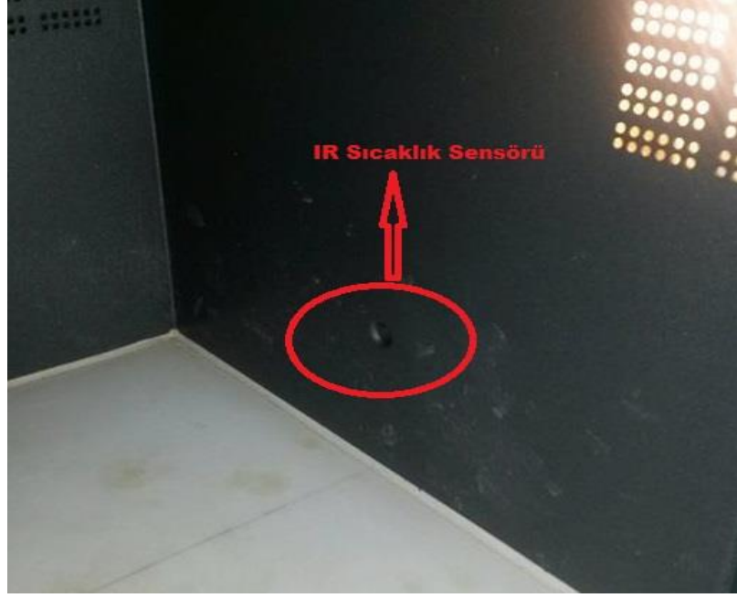
Şekil 3.2: Infrared (IR) sıcaklık sensörü.
