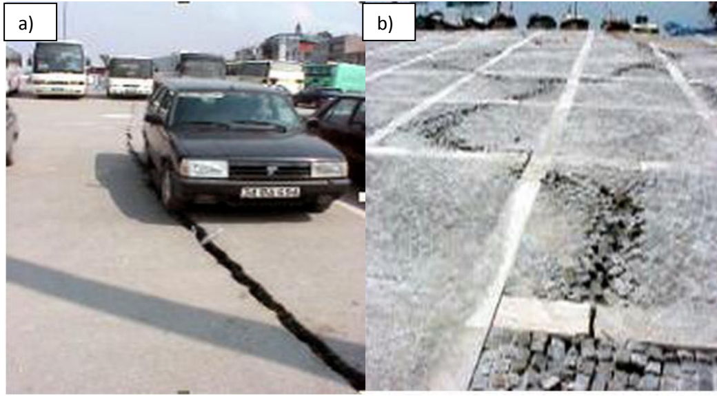
Şekil 4.15: Yalova Limanı'ndan 1999 depremi sonrası, a) araç park yerindeki ve b) usturmaçaların bulunduğu yerde gözlenen deformasyonlar.
