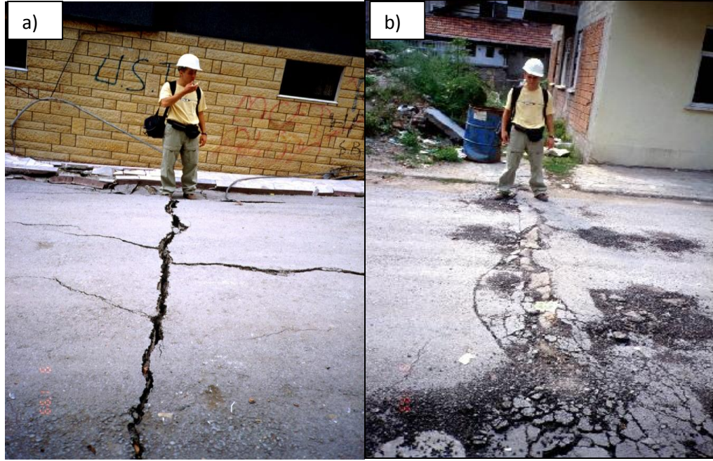
Şekil 4.18: Yakın Caddesi'nden 1999 depremi sonrası gözlenen a) derin çatlaklı ve b) yüzeysel çatlaklı deformasyonlar.
