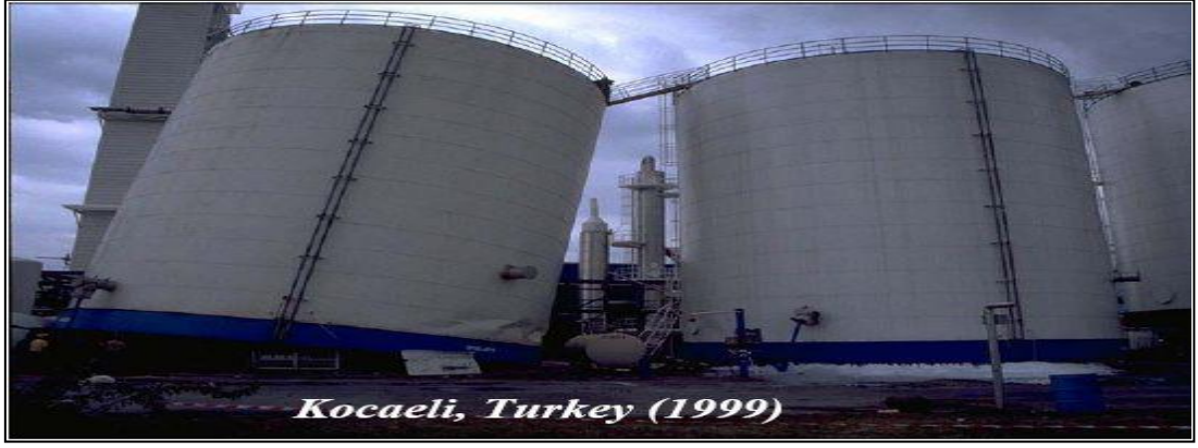
Şekil 2.24: Taşıma gücü kaybı sonucu deformasyona uğramış silolar Kocaeli Türkiye – 1999.
