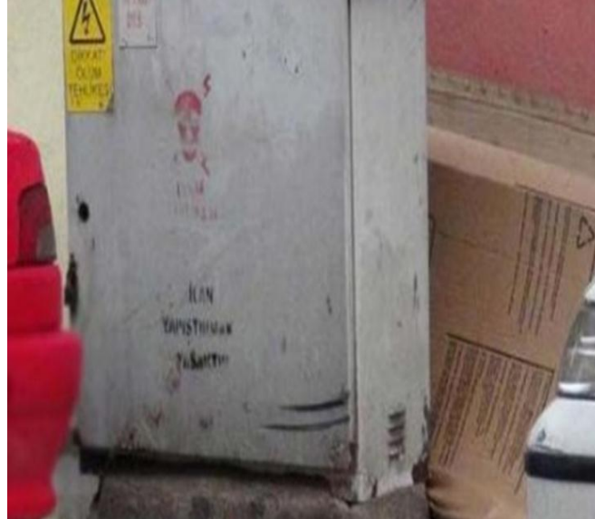
Şekil 3.1: Dolaylı temas sonucu oluşan ölümlü kaza.
