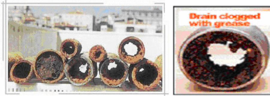
Foto 5: Bitkisel ve hayvansal atık yağlardan dolayı tıkanan kanal sistemleri görüntüleri
