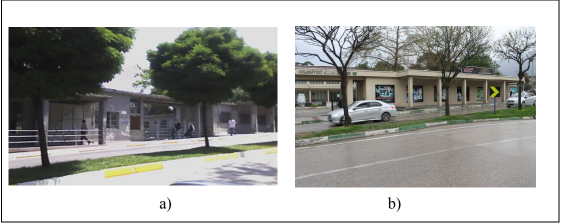
Şekil 2.63: T.-E.M.-R-T.K. İç Avluya Batı Yönünden (Merinos Caddesi'nden) Giriş a) Restorasyon Öncesi b) Restorasyon Sonrası.
