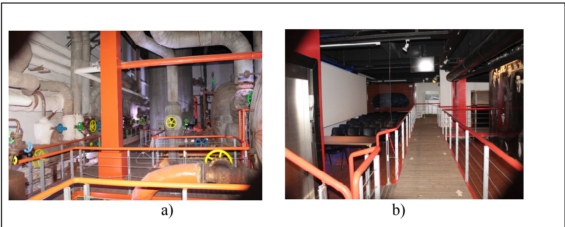
Şekil 2.44: Güç Merkezi Türbin Dairesi Pompa Bölümü Bodrum Kat a) Restorasyon Öncesi b) Restorasyon Sonrası.
