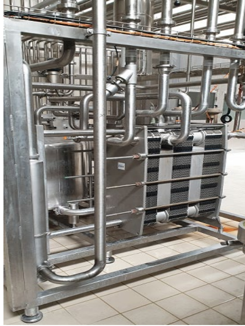
Şekil 3.2. Ön ısıtma ünitesi
