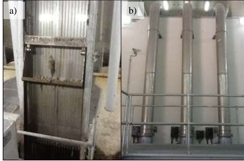
Şekil 4.3: a) İnce ızgara, b) terfi pompa istasyonu.
