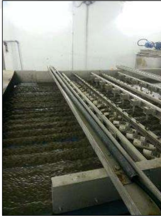
Şekil 4.9: Mekanik çamur yoğunlaştırma ünitesi.
