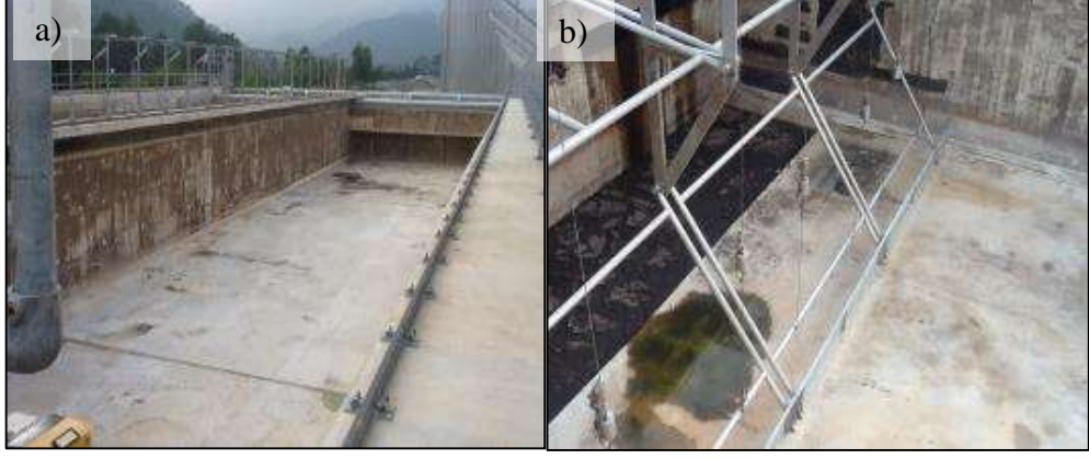
Şekil 4.5: a) Ön çökeltme havuzlarının boş görüntüsü, b) Ön çökeltme sıyrıcı sistemi.
