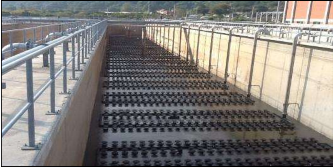
Şekil 4.7: Havalandırma havuzu ve yerleşimi.
