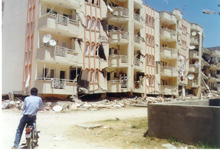
Foto 16: Ceyhan'da Hasevler Kooperatif binalarında zemin katın ezilerek yapının göçmesi (Bayülke, 1998).
