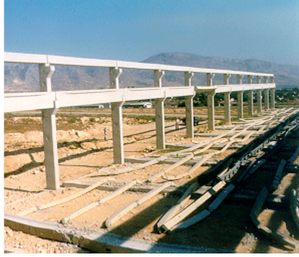
Foto 19: Prefabrik Yapılarda Oluşan Hasar (Bayülke, 1998).
