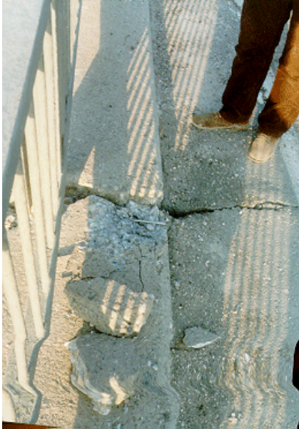
Foto 7: Adana-Gaziantep Yolundaki Köprüsü Hasarı (Bayülke, 1998)
