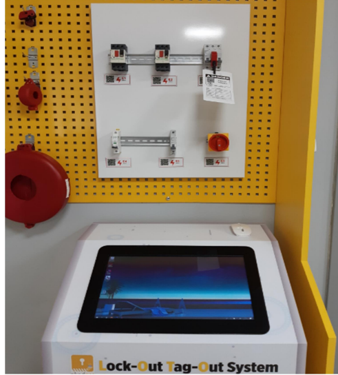
Şekil 5.25. LOTO iş güvenliği uygulaması
