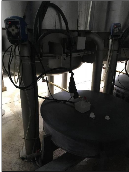
Şekil 3.4: Sızıntı suyu toplama tankı.
