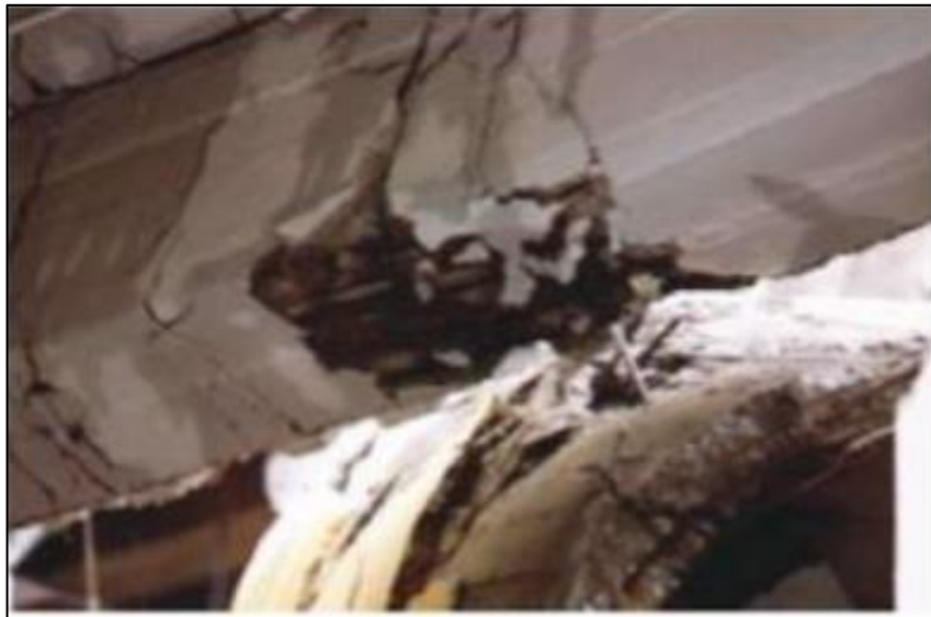
Şekil 2.25: Kiriş eleman hasarları.
