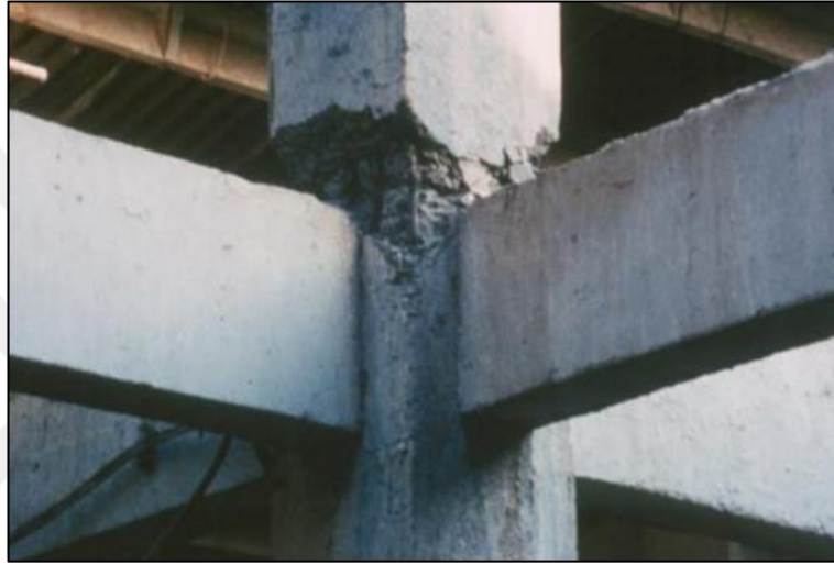
Şekil 2.27: Kolon-Kiriş birleşim hasarları.
