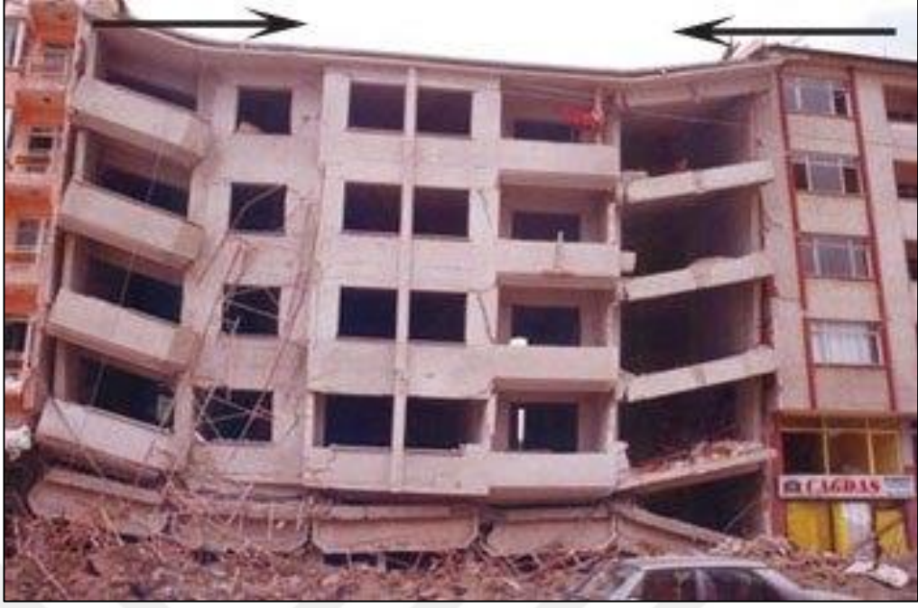
Şekil 2.28: Yumuşak kat hasarı.
