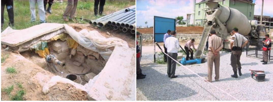
Foto 6: Gazlıgöl Beldesi'nde Açılmış Kaçak Sondaj Kuyusu Foto 7: Gazlıgöl Beldesi'nde Açılmış Kaçak Sondaj Kuyusunun Resmi Kurumlarca Kapatılması
