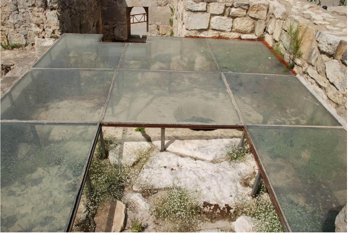
Levha:162 Alara Hanın cam+çelik çerçeve ile koruma altına alınmış ancak cam örtünün bir kısmı kırılmış ve içerisinde bitkilenmeler oluşmuş yıldız tonozu (2011)
