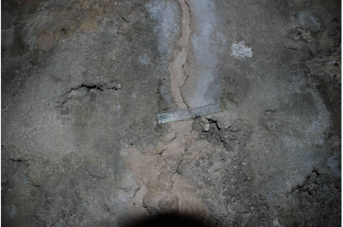
Levha:134 Şarapsa Han duvarlarındaki çatlak noktalara yerleştirilen cam lameller (2011)
