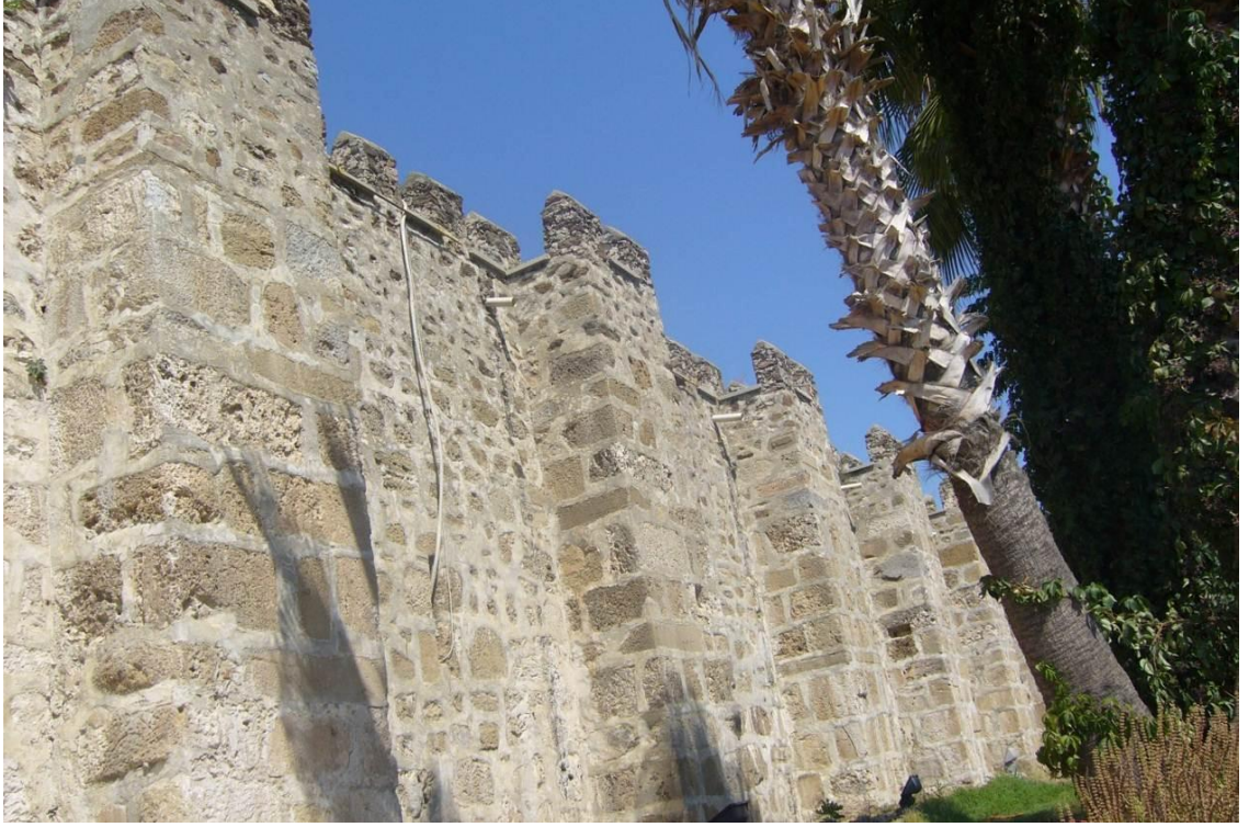
Levha:135 Şarapsa Han cephelerinde çörten yerine kullanılan pvc borular (2011)
