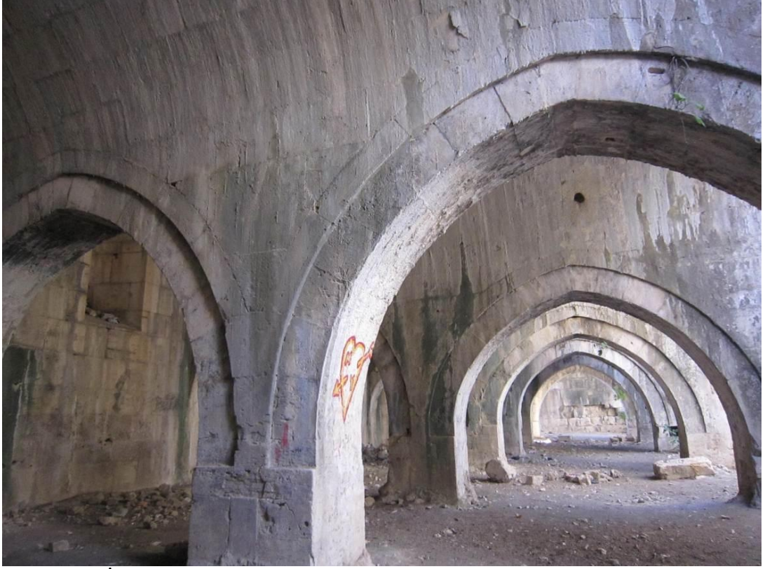
Levha:109 İncir Han üst örtünden gelen suların hanın duvarlarında meydana getirdiği tahribatlar (2011)
