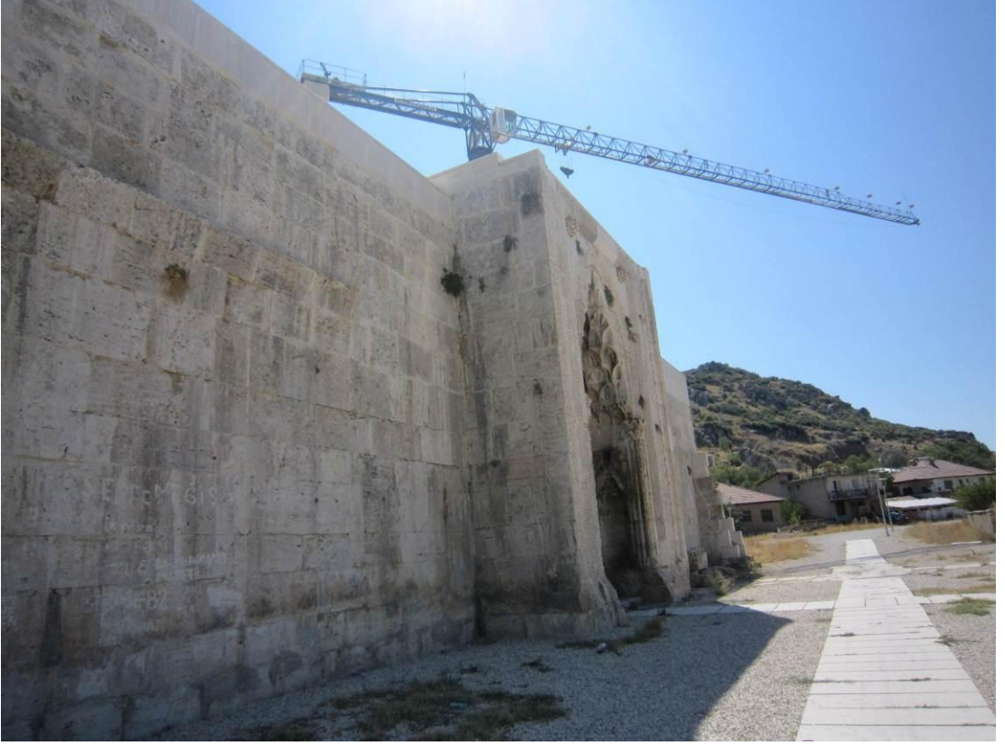
Levha:89 Susuz Han cephe beden duvarlarında oluşan bitkilenmeler (2011)
