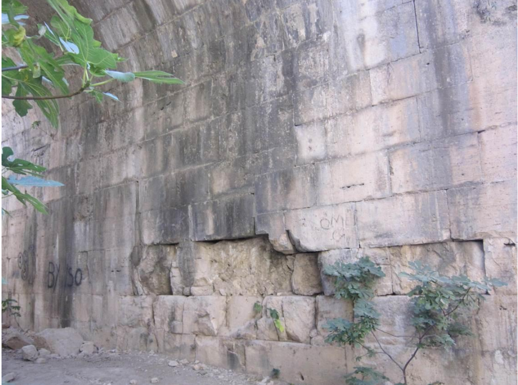
Levha:106 Īncir Han beden duvarlarındaki derz ayrılmaları, yerinden oynamalar ve tař dřmeleri (2011)
