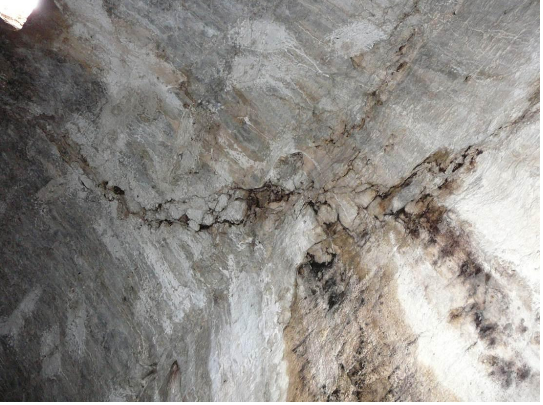
Levha:167 Alara Hanın üst örtüsünden aldığı suyun duvarlarında oluşturduğu çatlaklar (2011)
