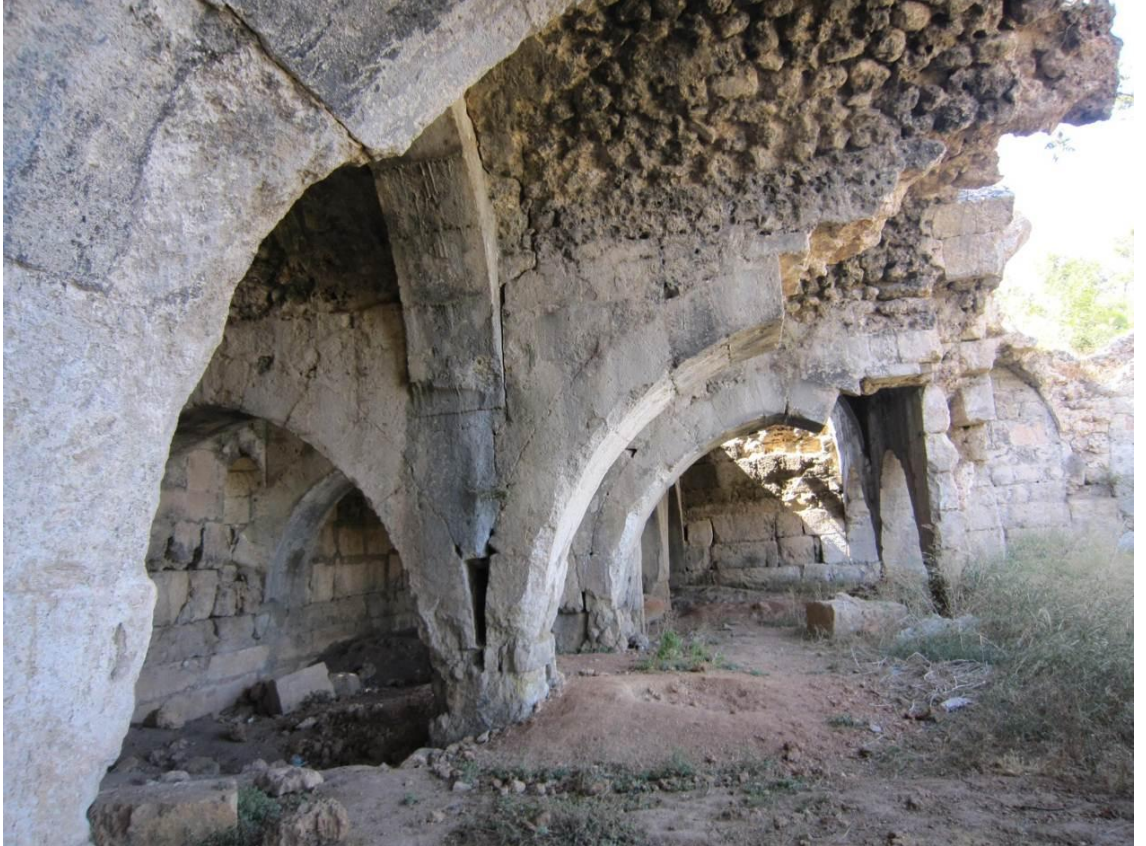
Levha:44 Emdir Hanın çöken üst örtüsü (2011)
