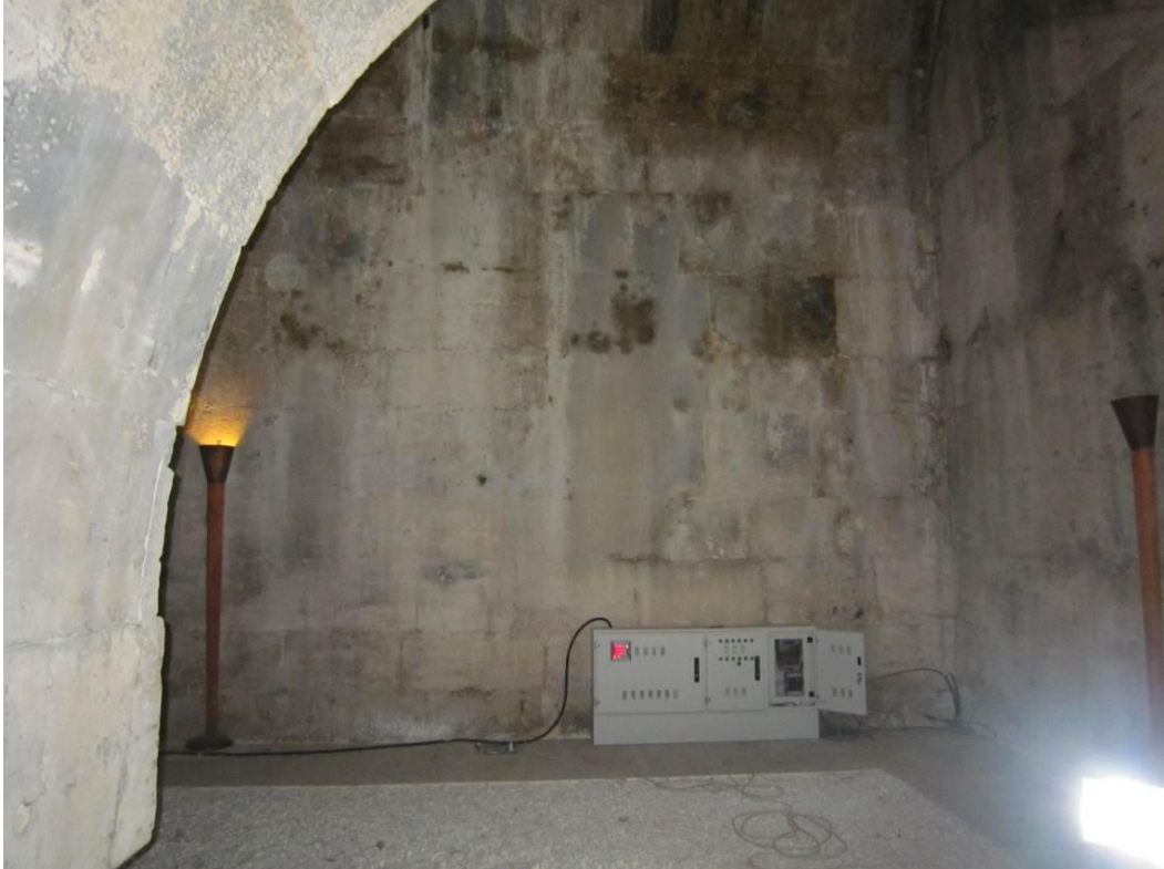
Levha:92 Susuz Han iç mekandaki duvar dibine yerleştirilmiş elektrik panosu (2011)
