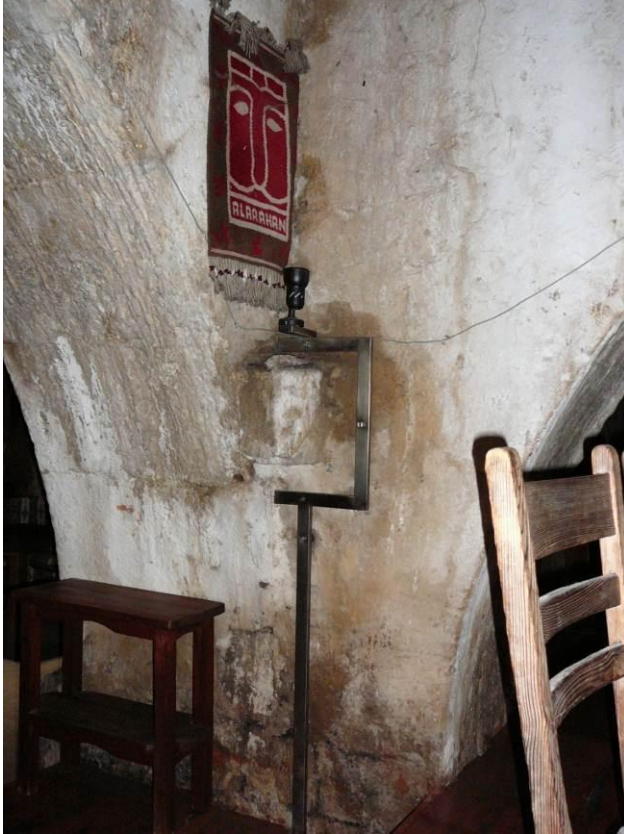
Levha:166 Alara Hanın duvarlarındaki su ve nem problemi (2011)
