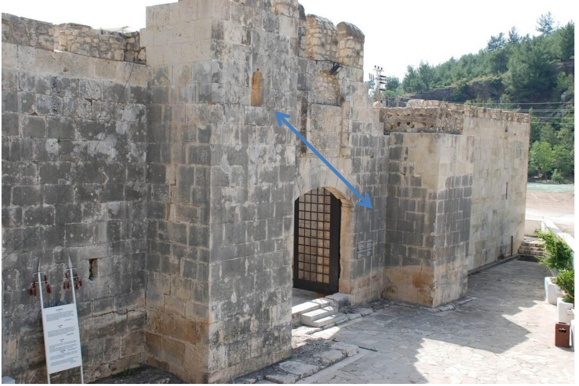
Levha:141 Alara Han kuzey cephe dođu payandasındaki pencere (2011)
