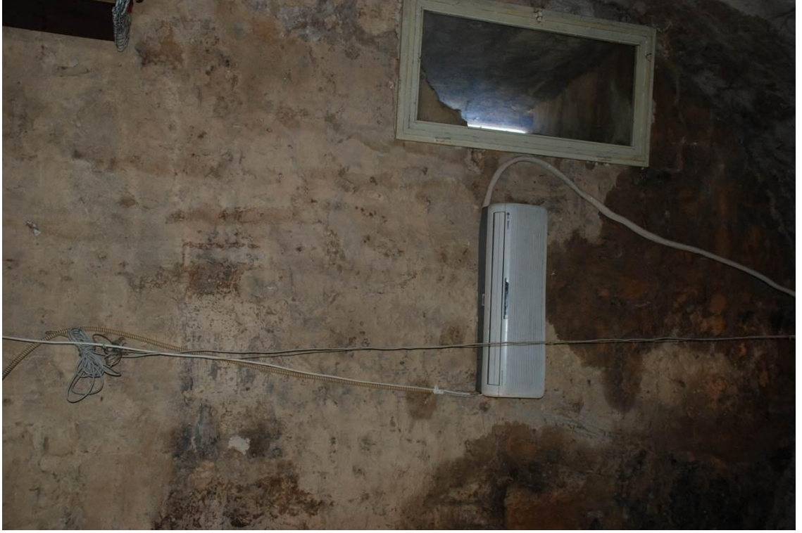
Levha:169 Alara Hanın duvarlarında görsel kirliliğe yol açan klima üniteleri ve açığa bırakılan elektrik kabloları (2011)
