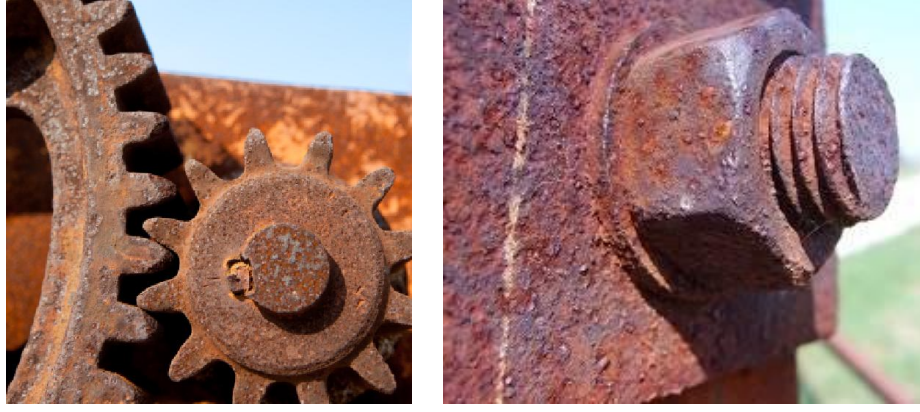
Fotoğraf 2.7. Bağlantı elemanları üzerindeki genel korozyon görünümleri
