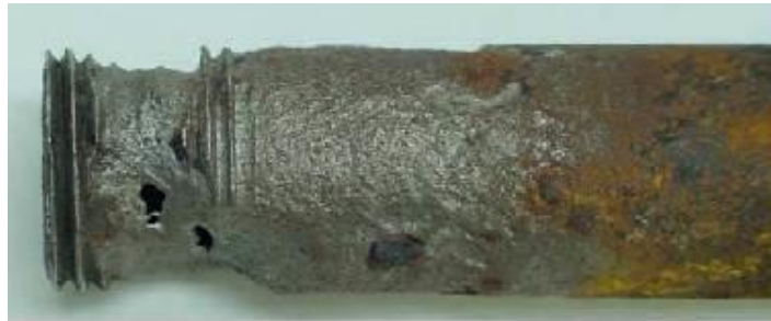
Fotoğraf 2.27. Bir boru diřli alanında çatlak korozyonu
