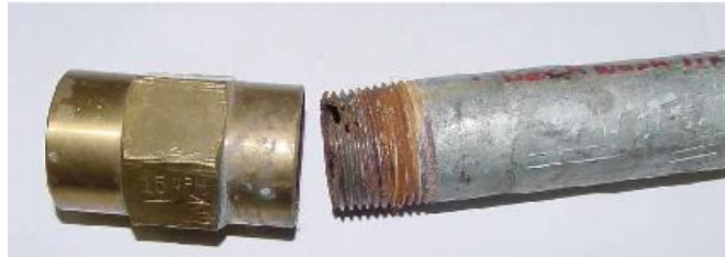
Fotoğraf 2.12. Bir su yumuşatıcı için çelik bir geri yıkama hattı ve pirinç bir bağlantı elemanı arasındaki dişli bir bağlantıda galvanik korozyon
