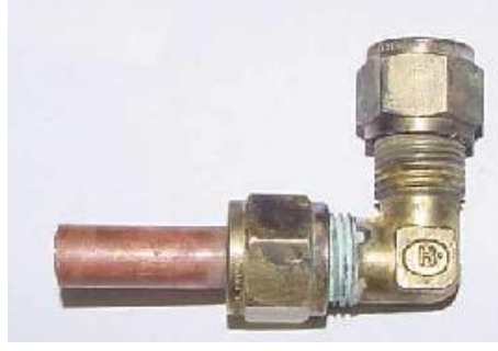
Fotoğraf 2.13. Bakır boru ile oluşturulan galvanik çift nedeniyle pirinç bağlantı elemanının korozyonu
