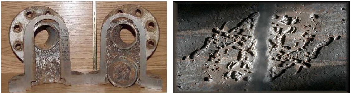
Fotoğraf 2.6. Korozyona uğramış yüzey görüntüleri
