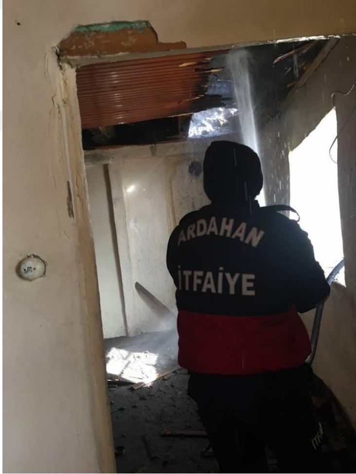
Şekil 18: Odanın tavanında çıkan yangına müdahale esnasında çekilmiş fotoğrafı
