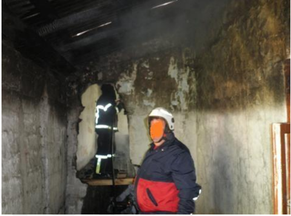
Şekil 23: Terkedilmiş bina yangınına müdahale esnasında olay yerinin içeriden çekilmiş fotoğrafı
