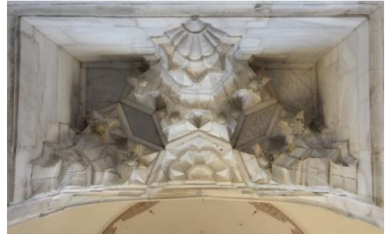
Şekil 221: Taçkapının Kavсарası Mukarnasının Alttan Görünümü.
