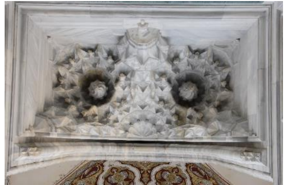
Şekil 468: Taçkapının Kavсарası Mukarnasının Alttan Görünümü.
