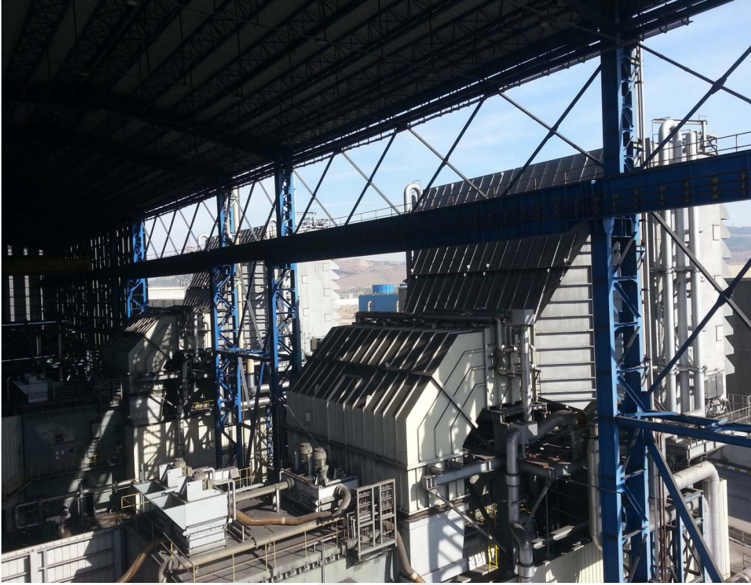
Şekil 3.2.1. 800MW santral görünümü
