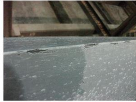
b)Sırt Köşe Çatlağı
