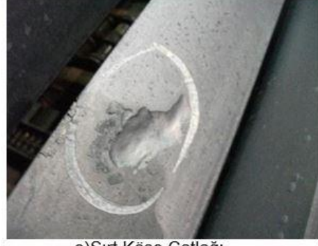
e)Sirt Köşe Çatlağı
