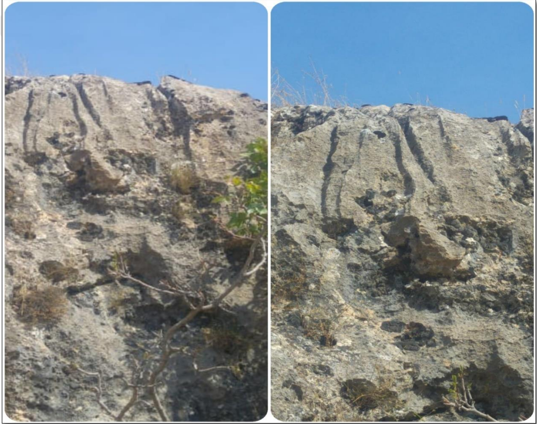
Fotoğraf 62 – Çalışma Alanında Görülen Duvar Lapyası
