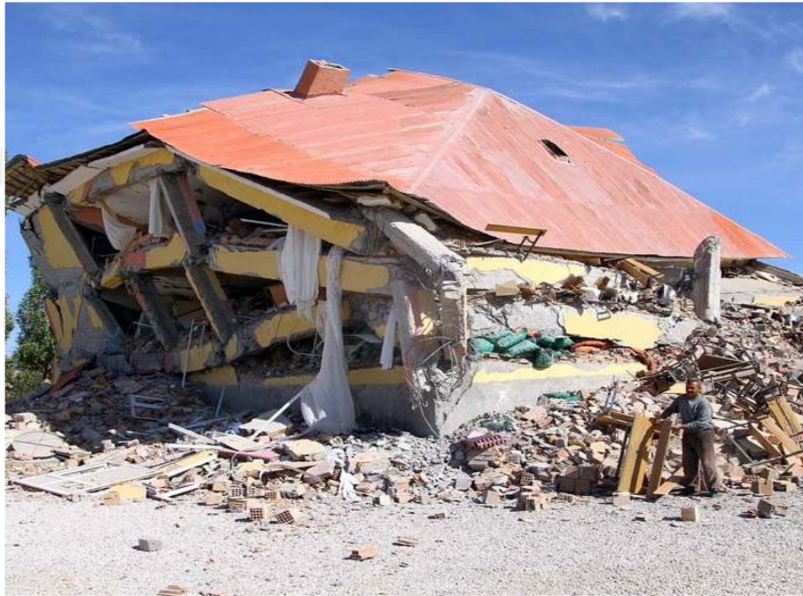
Şekil 2.6. Van Depremi'nin yol açtığı yıkım
