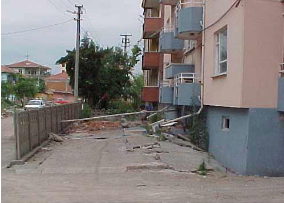
Şekil 2-8 1999 Kocaeli depreminde Adapazarı’nda zemine batmış bina [7].
