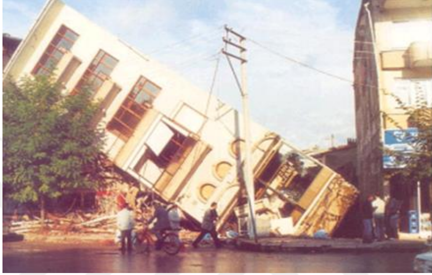
Şekil 2-4 Adapazarı’nda sıvılaşma nedeniyle yana yatmış bir bina [7].
