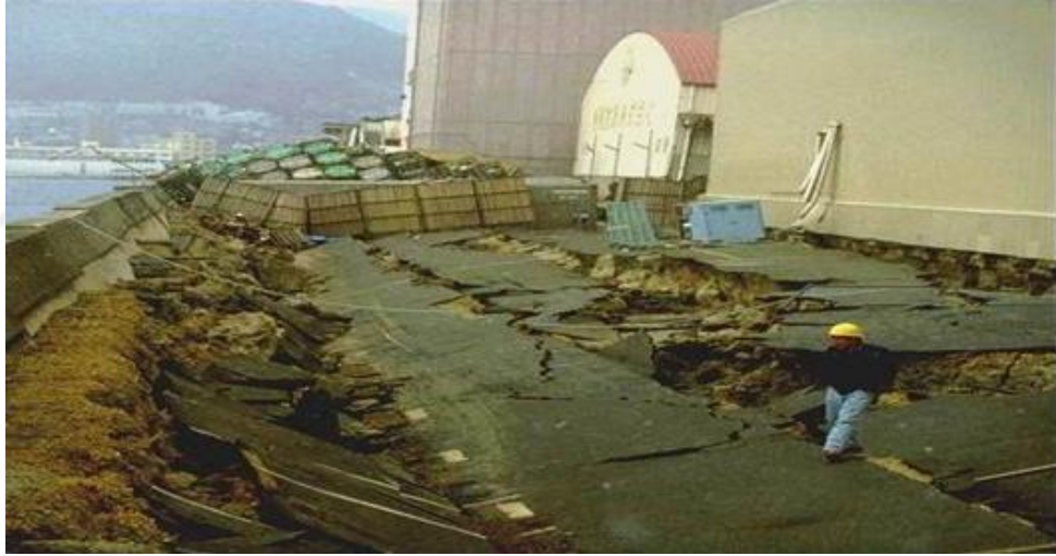
Şekil 2-11 Kobe (1995) depremi liman yapısındaki yanal yayılma hasarı [13].
