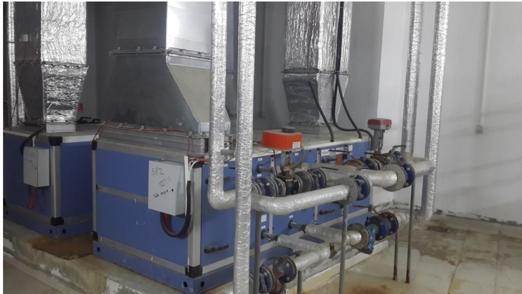
Şekil 3.6. Klima Santrali Isıtma ve Soğutma Batarya Bağlantıları
