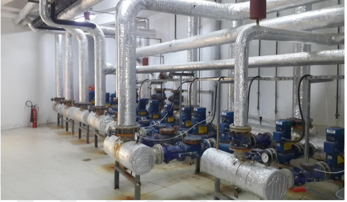
Şekil 3.3. Merkezi Soğutma Sistemi Pompa Dairesi
