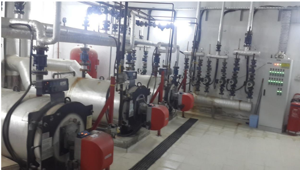
Şekil 3.1. Merkezi Isıtma Sistemi Kazan Dairesi Görünümü
