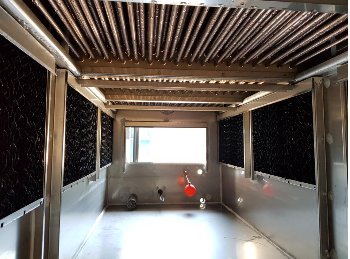
Şekil 3.20. Soğutma kulesinde su yönlendiriciler
