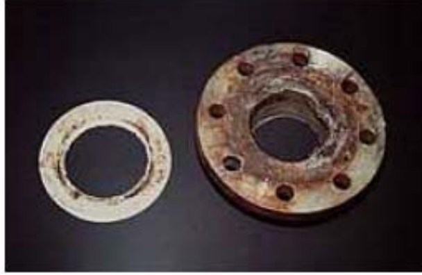
Şekil 2.5. Gerilme korozyonunun örneği [16].
